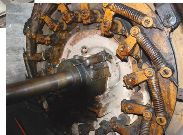
Turbine Kaplan Constructeur DUMONT
